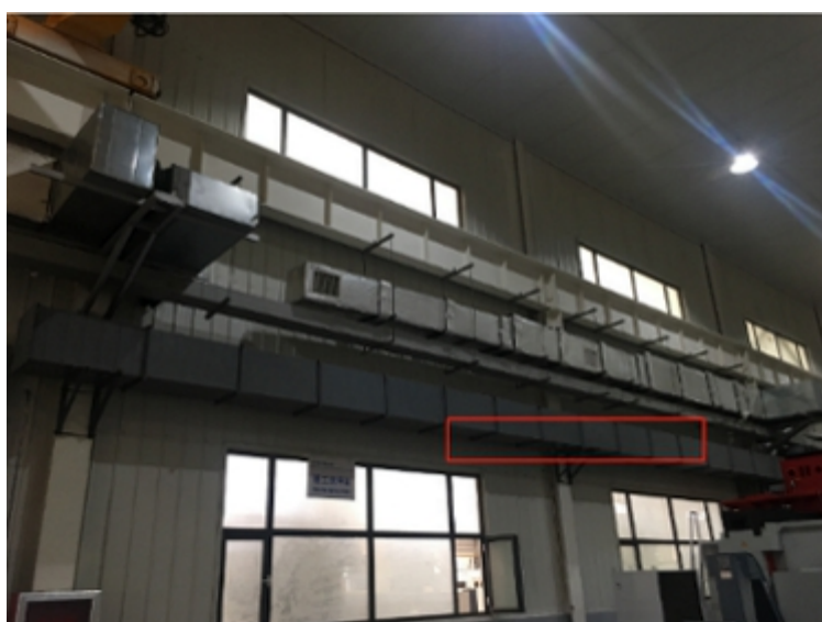
综合利用清洁能源及生产余热的冷热连供系统之车间输送管道
