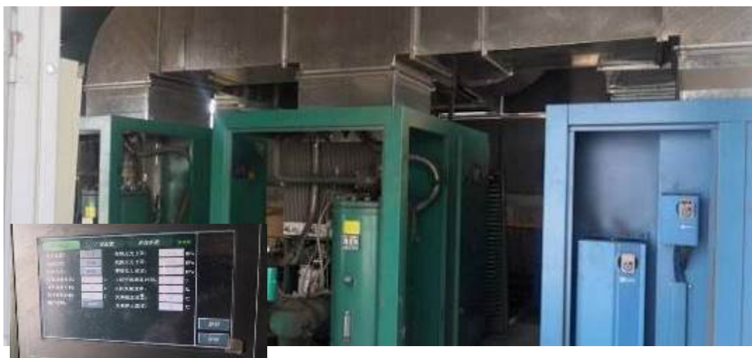
综合利用清洁能源及生产余热的冷热连供系统之变频空压机
